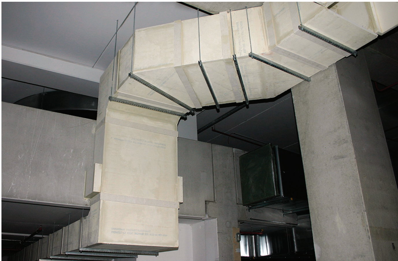
Ventilační potrubí z desek PROMATECT®
