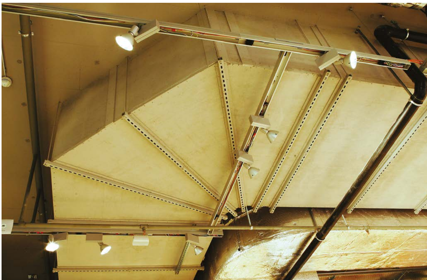
Ventilační potrubí z desek PROMATECT®
