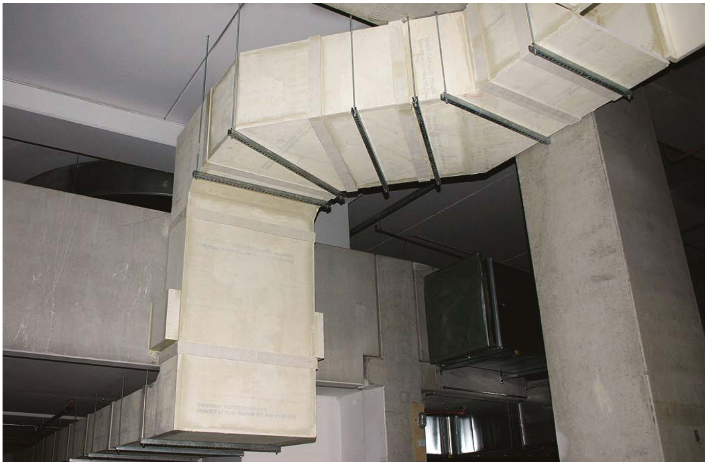
Ventilační potrubí z desek PROMATECT®
