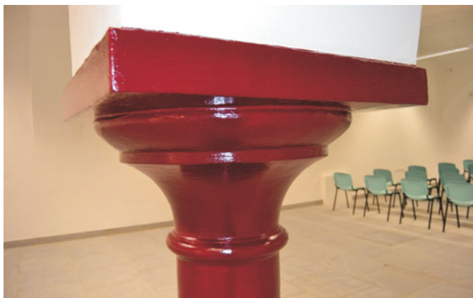
Foto 4 - Protipožární nátěr PROMAPAIN ® SC4
