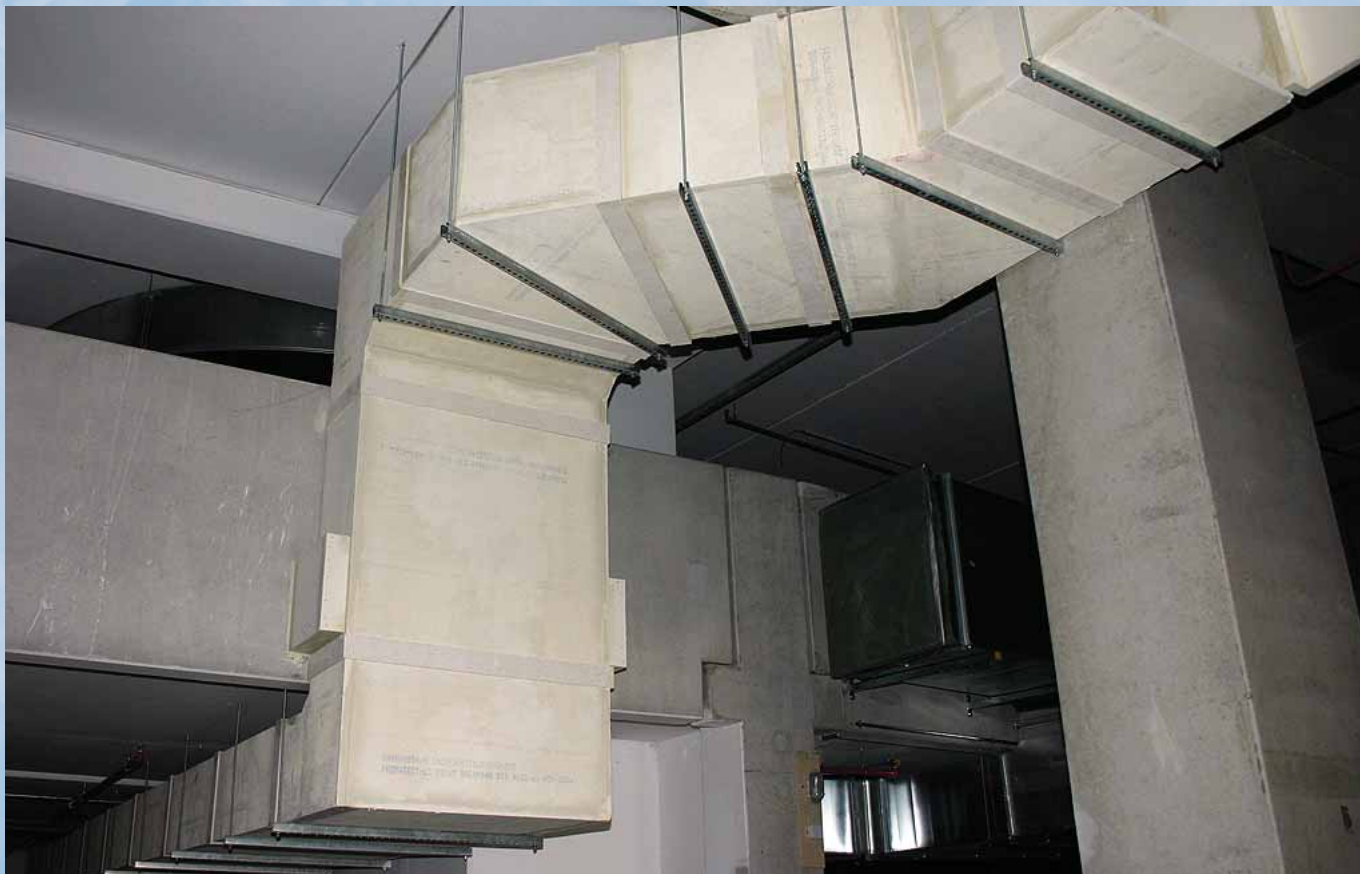
Ventilační potrubí z desek PROMATECT®
