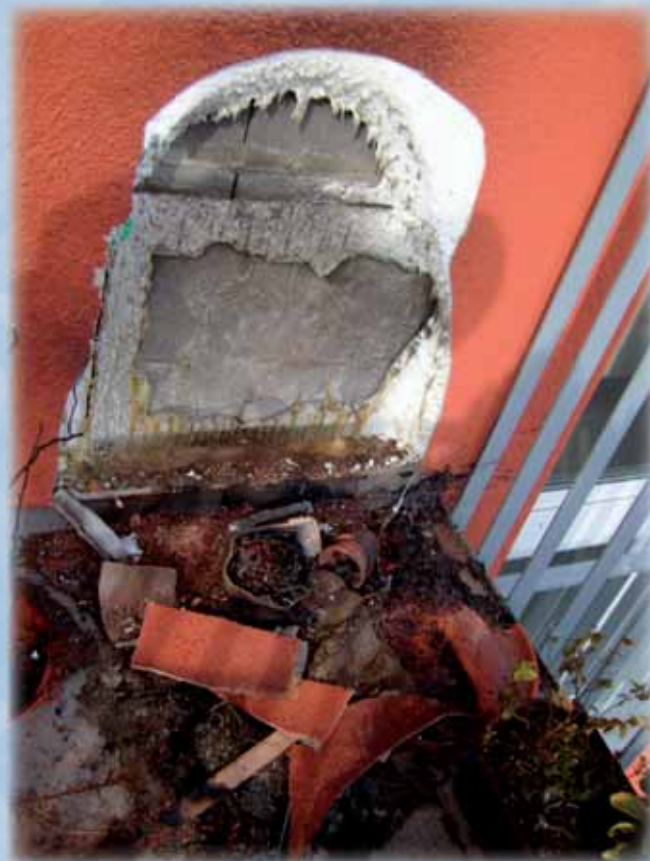
Vznícení obvodového pláště na balkoně panelového domu (poškození u založení KZS)
