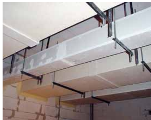
Kabelový kanál v CHÚC
